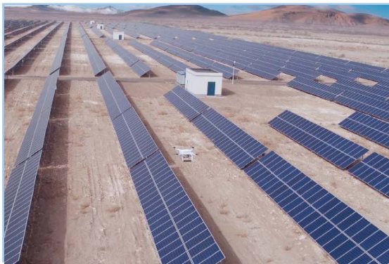
大型地面电站
